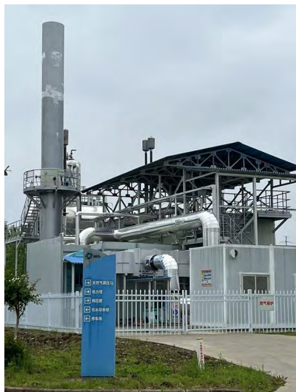
锅炉废气排气筒 25m
